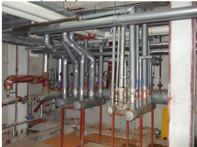
Fot. 45. Węzeł cieplny
