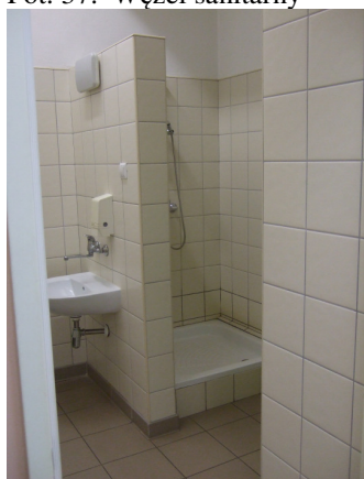
Fot. 37. Węzeł sanitarny
