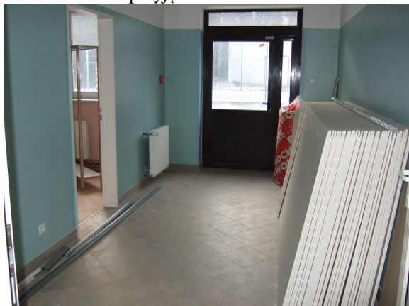
Fot. 1. Komora przyjęć
