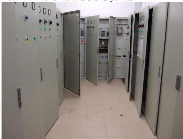
Fot. 44. Rozdzielnia elektryczna
