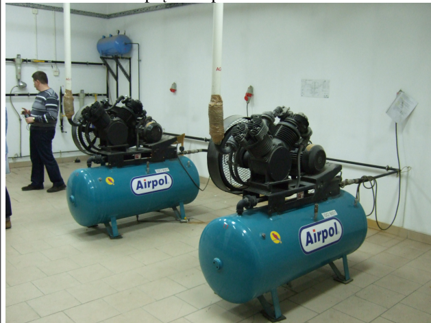
Fot. 46. Centrala sprężania powietrza
